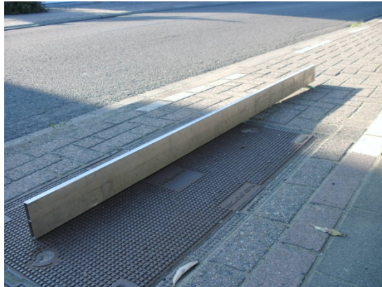
Foto 4.33 Er zijn slechts enkele deksels, maar deze zijn niet goed ingepast in het fietspad en worden vaak gevolgd door een plotse inzinking
