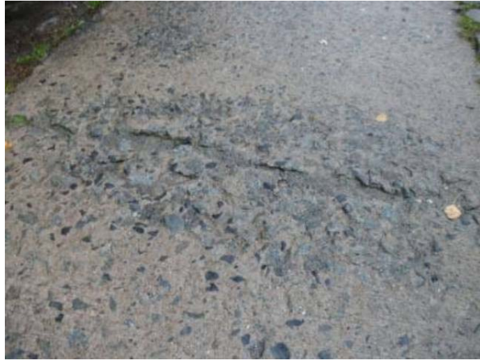
Foto 4.36 Afgesleten en uitgevreten materiaal
