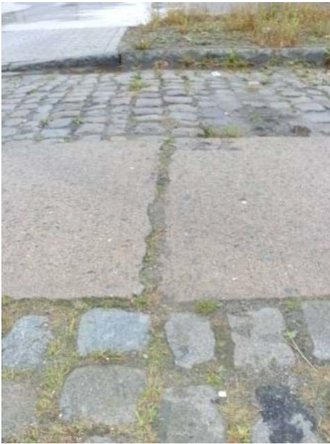
Foto 4.37 Betonplaten sluiten niet meer aan
